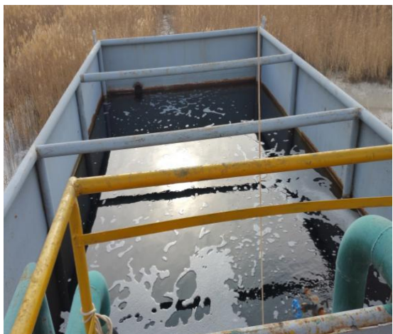
污水处理设施出口
